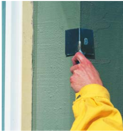
FOT. 4. Końcowa faza zatapiania kątownika narożnego w warstwie zaprawy klejącej przy użyciu kielni narożnikowej; fot.: Henkel
