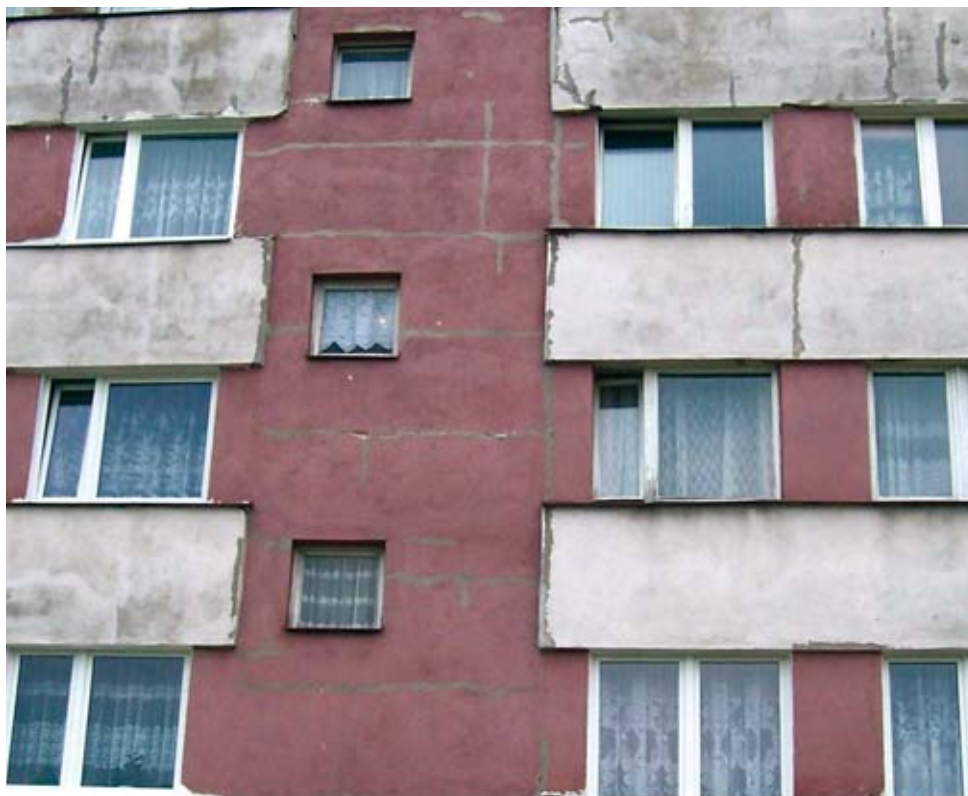
FOT. 1. Rysy występujące na tynku zewnętrznym; fot. M. Krzyżanowski
