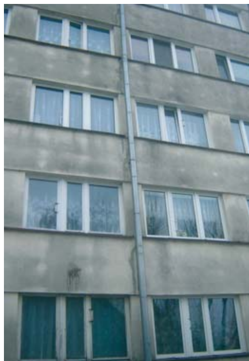
FOT. 6. Zacieki na elewacji spowodowane nieszczelnością rury spustowej; fot. M. Krzyżanowski
