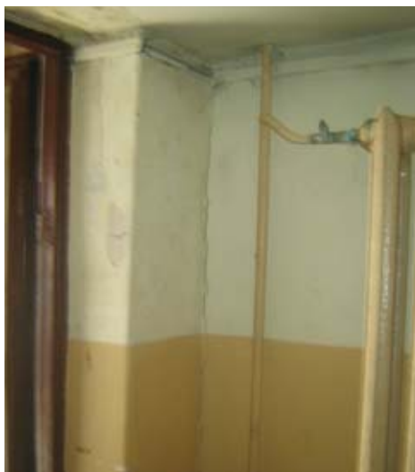
FOT. 16. Pęknięcie na styku ściany wiatrołapu i ścian konstrukcyjnych budynku; fot. M. Krzyżanowski
