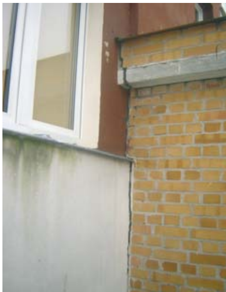
FOT. 12. Odspojenie ścian wiatrołapu od ściany budynku; fot. M. Krzyżanowski
