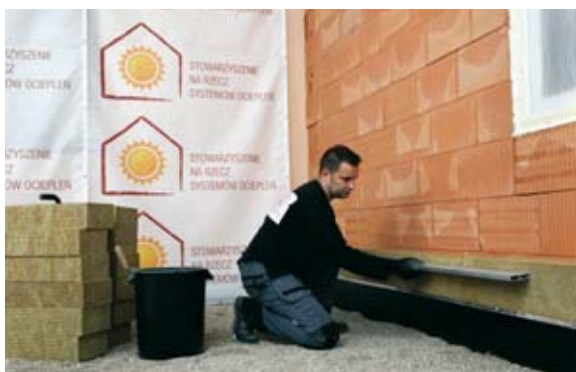
FOT. 2. Wykonanie warstwy termoizolacyjnej przy zastosowaniu wełny mineralnej; fot.: Stowarzyszenie na rzecz Systemów Ociepleń
