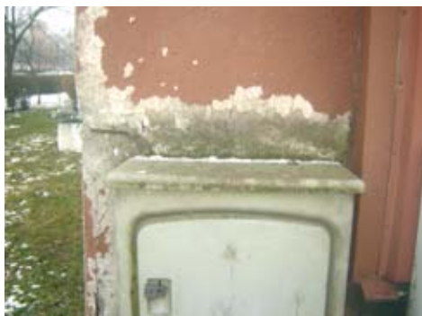
FOT. 13. Uszkodzenie ściany spowodowane zbyt bliską lokalizacją szafki telekomunikacyjnej; fot. M. Krzyżanowski
