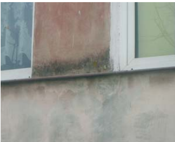
FOT. 2. Glony w miejscu obróbek blacharskich; fot. M. Krzyżanowski
