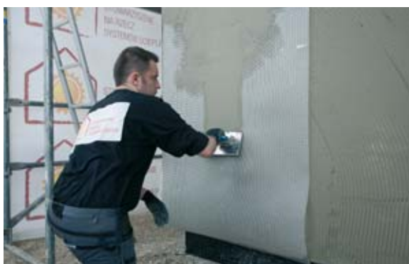
FOT. 3. Wykonanie warstwy zbrojonej – zatapiać siatkę z włókna szklanego w zaprawie klejącej; fot.: Stowarzyszenie na rzecz Systemów Ociepleń
