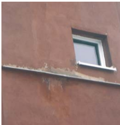
FOT. 9. Zawilgocenie ścian w miejscach obróbek blacharskich; fot. M. Krzyżanowski
