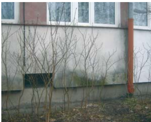
FOT. 3. Glony na elewacji północnej budynku; fot. M. Krzyżanowski
