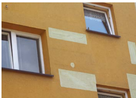
FOT. 18. Skutki naprawy rysy tylko na podstawie pobieżnej diagnostyki, bez sprawdzenia stanu podłoża; fot.: autor
