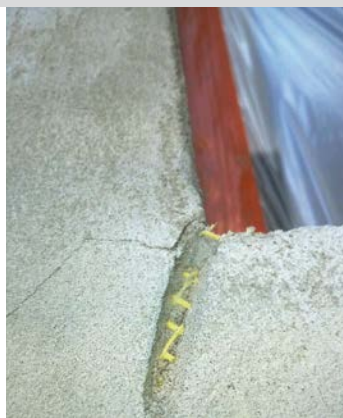
FOT. 19. Przykład rysy w narożu pomimo wykonania zbrojenia siatkami diagonalnymi (por. RYS.); fot.: autor
