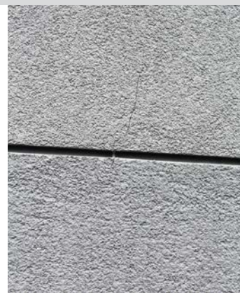
FOT. 24. Ocieplenie z niemal czarną wyprawą tynkarską i rysa będąca skutkiem nagrzewania się powierzchni; fot.: autor
