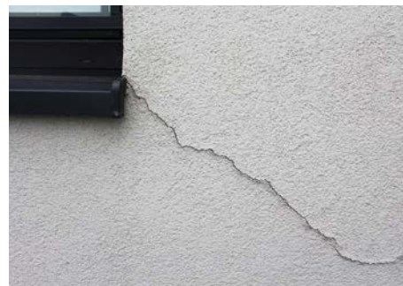
FOT. 2. Bardzo typowe uszkodzenie: spękanie tynku strukturalnego zaczynające się w narożniku otworu okiennego; fot.: autor
