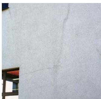
FOT. 11. Widok ściany z rysą ukośną przechodzącą z pionową; fot.: autor
