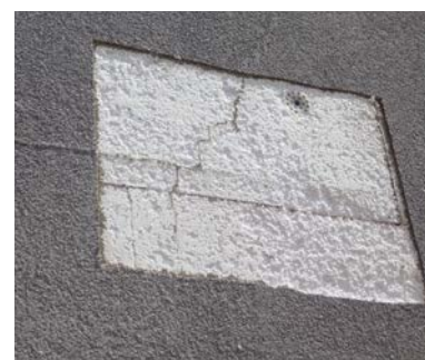
FOT. 12. Odkrywka w miejscu zmiany kierunku rysy; fot.: autor
