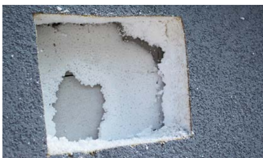
FOT. 10. Pod właściwą termoizolacją stwierdzono obecność podklejki styropianowej, co determinuje usunięcie ocieplenia; fot.: autor
