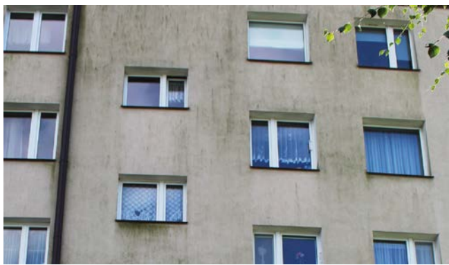
FOT. 2. Rozwój grzybnicy na powierzchni tynku; fot.: autorzy
