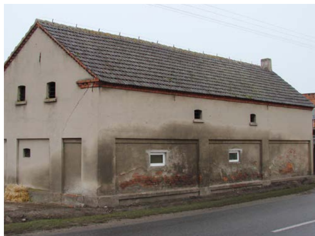
FOT. Budynek zawilgocony na skutek braku prawidłowej ochrony przed wodą; fot.: autor
