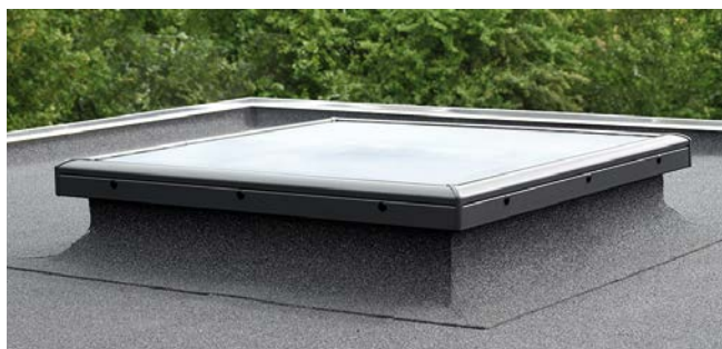
FOT. 3. Okno prawidłowo zamontowane na dachu płaskim; fot.: VELUX
