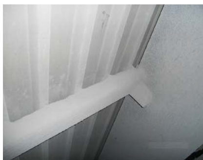
FOT. 1. Wnętrze hali fabrycznej z widoczną zalegającą warstwą pyłu cementowego na ścianie; fot.: autorzy
