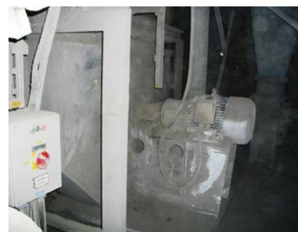
FOT. 2. Wnętrze hali fabrycznej z widoczną zalegającą warstwą pyłu cementowego na wentylatorze, stanowiącym wyposażenie hali; fot.: autorzy
