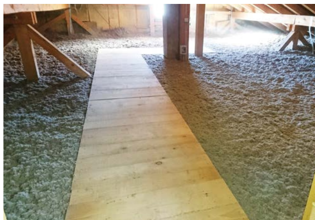
FOT. 3. Strop ocieplony w otwartym nadmuchu. Widoczna podłoga techniczna; fot.: materiał firmy IsoCELL GmbH
