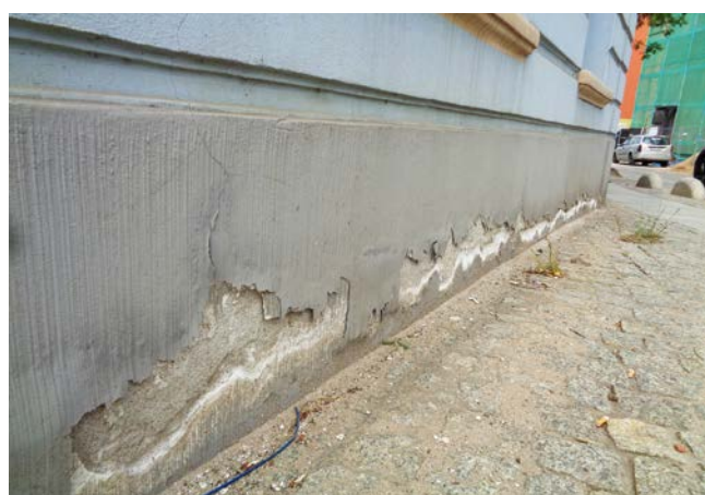
FOT. Najczęściej występujące uszkodzenia w strefie cokołowej: łuszczenie się powłok malarskich, wykwit solny oraz odspojenia tynków; fot.: autor
