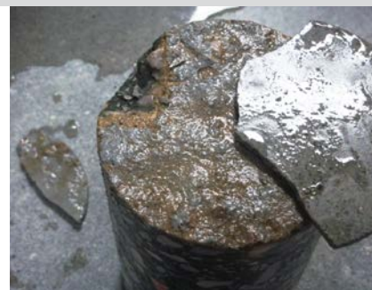
FOT. 3. Odspojona od podłoża (podkładu) warstwa utwardzona (przykład – hala nr 3);
