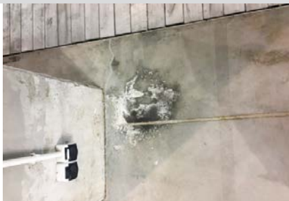
FOT. 10. Nieprawidłowy układ szczelin dylatacyjnych przy słupie (przykład – hala nr 4); fot.: T. Majewski
