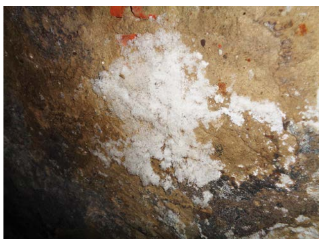
FOT. Mury o ekstremalnym stopniu zasolenia wymagają odpowiednich działań osłonowych; fot.: autor
