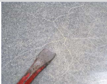
FOT. 2. Rysy na powierzchni posadzki wywołane skurczem (przykład – hala nr 3);
