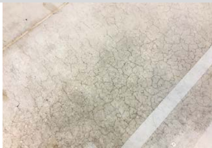
FOT. 11. Włoskowate rysy skurczowe na powierzchni posadzki, tzw. skóra krokodyla (przykład – hala nr 4); fot.: T. Majewski
