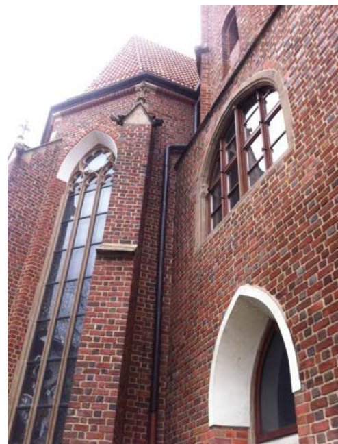
FOT. Budynek kościoła pw. św. Macieja we Wrocławiu, przy pl. Nankiera 17a, gdzie została zastosowana technologia bezinwazyjnego systemu osuszania Aquapol
