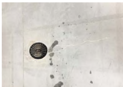
FOT. 8. Rysa w bezpośrednim sąsiedztwie studzienki hydrantowej (przykład – hala nr 4); fot.: T. Majewski
