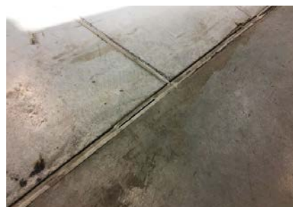
FOT. 9. Nieprawidłowo wykonane skrzyżowanie szczelin dylatacyjnych. Uszkodzona masa elastyczna, odspojona od betonu (przykład – hala nr 4); fot.: T. Majewski
