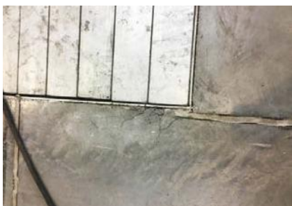
FOT. 7. Uszkodzona krawędź betonu przy korycie kablowym, masa elastyczna odspojona od betonu (przykład – hala nr 4); fot.: T. Majewski
