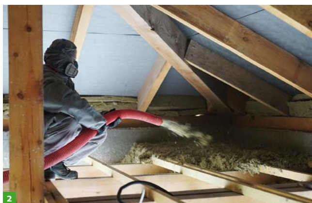
FOT. 1–2. Aplikacja izolacji wdmuchiwanej z włókien celulozowych (1) oraz z granulatu z wełny mineralnej (2); fot.: Derowerk (1), Rockwool (2)
