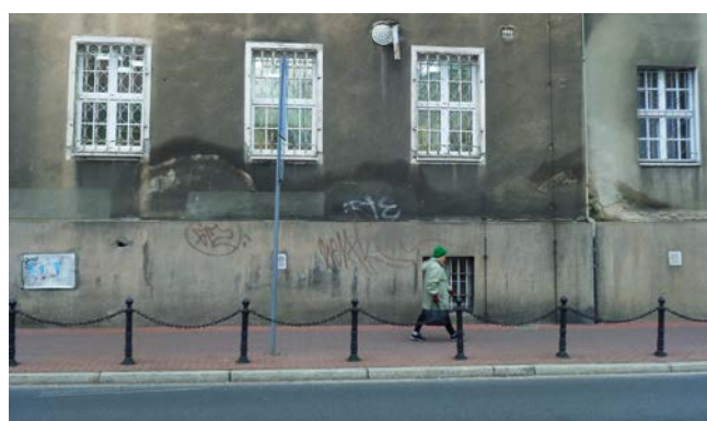
FOT. Zawilgocenie ścian zewnętrznych na skutek kapilarnego podciągania wilgoci z gruntu; fot.: autor
