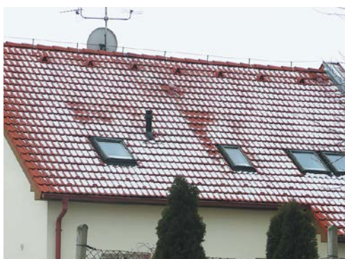
FOT. 13. Pod każdą dachówką znajduje się warstwa powietrza zamknięta w przestrzeni utworzonej przez olatowanie. W takim wypadku albo nie ma wlotu do szczeliny w okapie, a MWK jest zbyt wypchnięta do góry, albo pod dachówką znajduje się nieizolowane źródło ciepła; fot.: K. Patoka
