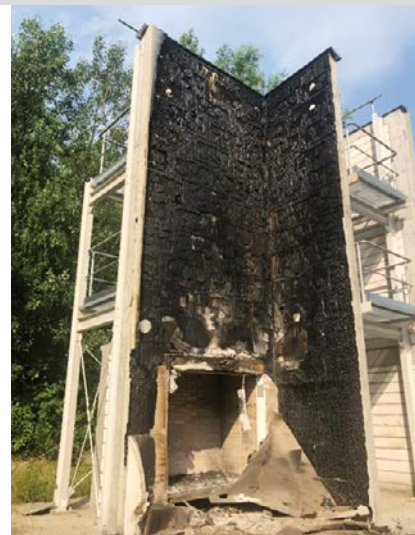
FOT. 11. Widok ściany EPS z nadprożem z wełny mineralnej po usunięciu warstwy zbrojonej; fot.: autorzy
