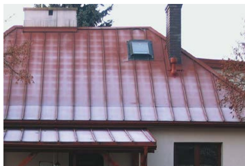
FOT. 2. Zdjęcie ilustruje dach pokryty blachą arkusową łączoną na rąbek stojący. Topniejący śnieg w wielu miejscach wskazuje miejsca występowania mostków cieplnych – na tych częściach dachu, przez które ucieka ciepło, nie ma szronu lub śniegu. Ta połać ocieplona jest stosunkowo dobrze; fot.: K. Patoka
