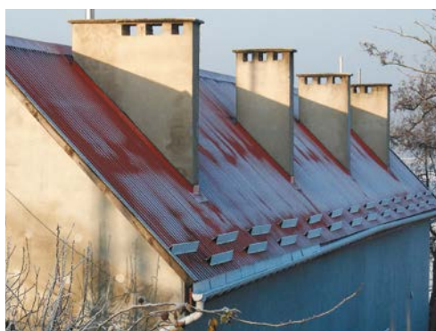
FOT. 14. Zdjęcie ilustruje bardzo ciekawy przykład wskazujący różnicę między pokryciem wentylowanym a niewentylowanym. Blaszana osłona wlotu do szczeliny pod profilem blachy trapezowej znajdująca się w rynnie blokuje dopływ powietrza wentylującego i odprowadzającego ciepło; fot.: K. Patoka
