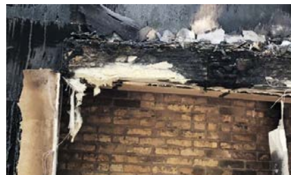
FOT. 8. Widok nadproża komory spalania po badaniu; fot.: autorzy
