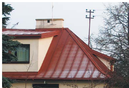
FOT. 3. Na zdjęciu przedstawiono ten sam dach, co na FOT. 2, lecz z drugiej strony. Dobrze widać, że przez dolną, niewidoczną część ściany lukarny ucieka pod pokrycie dachu dużo ciepła. Ściana jest ocieplona, ale tylko powyżej pokrycia i dlatego blacha przy lukarnie jest ciepła; fot.: K. Patoka
