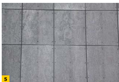
FOT. 3–6. Przykłady elewacji wentylowanych budynków, w których płyty włóknisto-cementowe uległy przyspieszonemu starzeniu; fot.: autor
