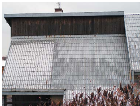
FOT. 5. Pokrycie tego dachu stanowi blaszana dachówka trapezowa ułożona na deskowaniu z papą. Wyraźnie widać trzy strefy topnienia śniegu. Tam, gdzie go nie ma, występują największe straty energii, a w miejscach, gdzie leży pod dachem, znajduje się taras – nieocieplony, ale bez dopływu ciepła; fot.: K. Patoka
