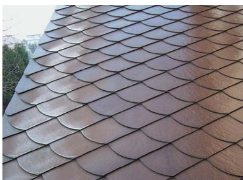
FOT. 6. Ten dach nieogrzewanego przedsionka domu jednorodzinnego pokryty jest płytką włóknocementową ułożoną w stylu staroniemieckim. W miejscach, w których nie ma szronu, następuje ucieczka ciepła z wnętrza domu. Szron leży na tej części, która styka się z zimnym murem; fot.: K. Patoka
