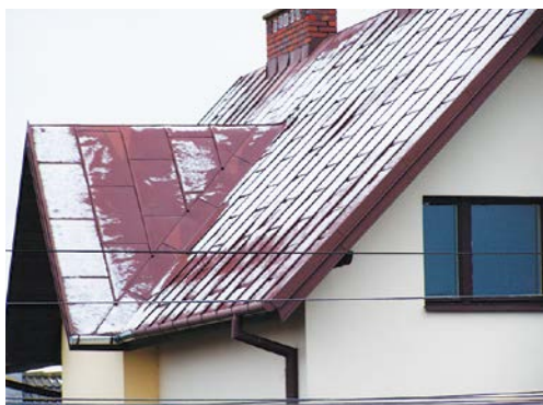
FOT. 4. Odsonięta blacha bez śniegu pokazuje typowy przypadek braku izolacji termicznej nad klatką schodową. Ciepło zbiera się na klatce i ucieka przez źle zaizolowany dach. Jest to duży błąd wynikający z pozornych oszczędności materiałowych; fot.: K. Patoka
