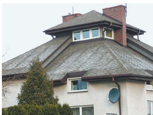
FOT. 7. Na tym dachu krokwie przewodzą ciepło z wnętrza budynku. W Polsce dachy pokryte dachówką bitumiczną bardzo rzadko są wentylowane tak, jak pokazano to na RYS. 2, gdzie nie ma mostka w miejscu krokwi. Ciepło ucieka też przez nieocieplony okap i mur za nim; fot.: K. Lenart
