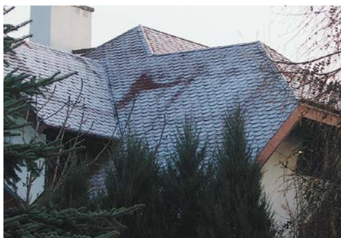
FOT. 11. Na tym dachu widać bardzo wyraźne skutki zbyt wysokiego murowania szczytów. Brak izolacji między murem a poszyciem dachu oraz brak wentylacji powoduje bezpośrednią ucieczkę ciepła, tak jak przez uchylone okno. Na zdjęciu dobrze widać, gdzie znajduje się najcieplejsza ścianka wewnętrzna; fot.: K. Patoka
