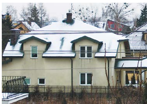
FOT. 12. Na tym dachu można zaobserwować wszystkie błędy będące przyczyną strat ciepła: źle ocieplone kominy, lukarny oraz mostki cieplne na połączeniach dachu ze ściankami. Brak śniegu przy lukarnach jest w pewnym stopniu również skutkiem ostonowego działania okapu; fot.: K. Patoka
