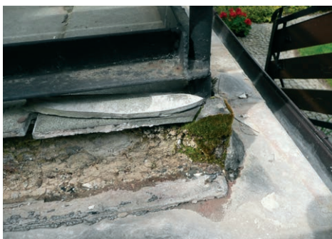
FOT. 6. Skutek bezmyślnego obsadzenia barierki i błędów w wykonaniu jastrychu dociskowego i okładziny; fot.: autor
