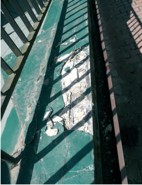
FOT 7. Wykonanie warstwy użytkowej z żywicy wymaga rozwiązania wielu problemów, w przeciwnym razie efekt będzie taki, jak na zdjęciu; fol.: autor
