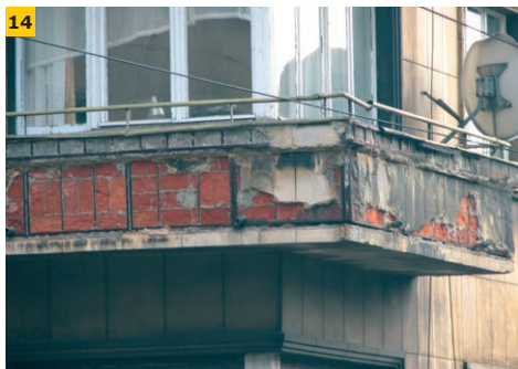
FOT. 13–14. Balkony z balustradą pełną wymagają szczególnej staranności w zaprojektowaniu i wykonaniu. W przeciwnym razie efekt będzie taki, jak widać na zdjęciach; fol.: autor
