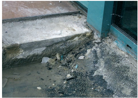
FOT 10. Beźmyślnie wykonany detal – w tym miejscu powinna być dylatacja obwodowa; fol.: autor
