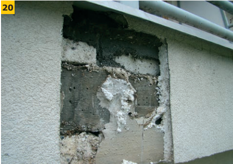
FOT. 19–20. Skutki bezmyślnego zaprojektowania i błędnego wykonania balkonu ocieplonego (widok z góry i odkrywka z boku); fot.: autor
