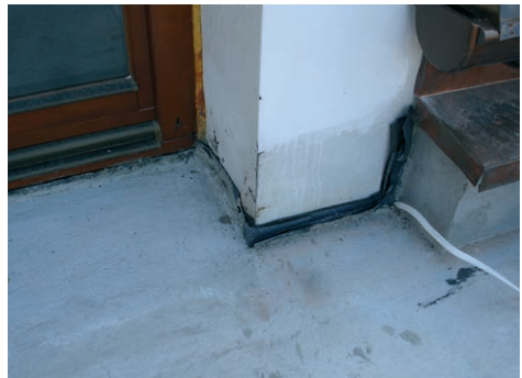
FOT 11. Takie ułożenie papy nie może być traktowane jako wykonanie dylatacji obwodowej. Dodatkowo widoczny przewód elektryczny, którego uszczelnienie jest bardzo kłopotliwe. Brak koordynacji poziomów warstw w obszarze progu drzwiowego; fol.: autor
