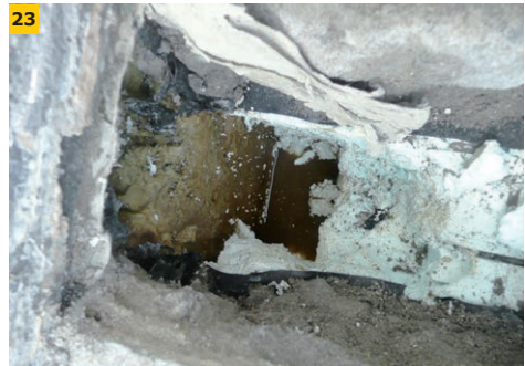
FOT. 22–23. Zawilgocenia progu drzwiowego tarasu od strony pomieszczenia oraz ich przyczyna; fot.: autor
