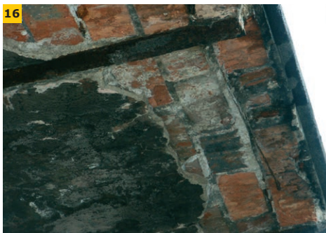
FOT. 15–16. Skutki błędów w wykonaniu oraz braku koniecznych napraw; fol.: autor
