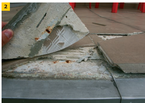
FOT. 1–2. Uszkodzenie płytek na skutek braku dylatacji i błędów w wykonaniu strefy okapowej; fot.: autor
