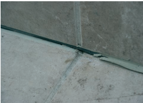
FOT 8. Uszkodzenie dylatacji brzegowej na skutek zbyt dużych ruchów termicznych i niewłaściwego nałożenia masy dylatacyjnej; fol.: autor
