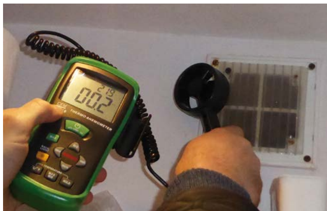
FOT. Sprawność wentylacji jest ważnym elementem w utrzymaniu właściwego mikroklimatu w pomieszczeniach; fot.: autor
