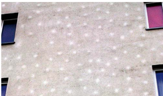
FOT. Przykłady niepoprawnego zastosowania łączników mechanicznych – tzw. efekt biedronki; fot.: blogspot.com.pl
