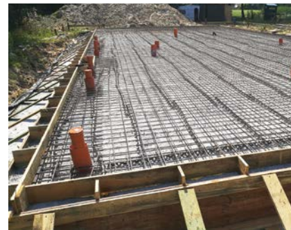
FOT. 6. Zazbrojona płyta na podbudowie z pianobetonu; fot.: autor
