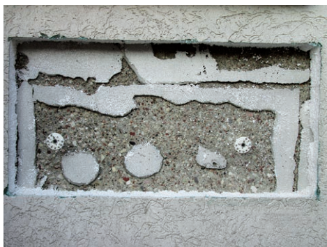
FOT. 1. Istniejące ocieplenie zamocowane prawidłowo; fol. archiwum autora
