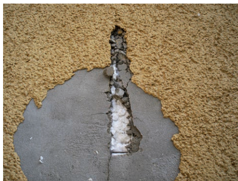
FOT. 18. Brak ciągłości zbrojenia (siatki z włókna szklanego) w warstwie kleju; fot. archiwum autora
