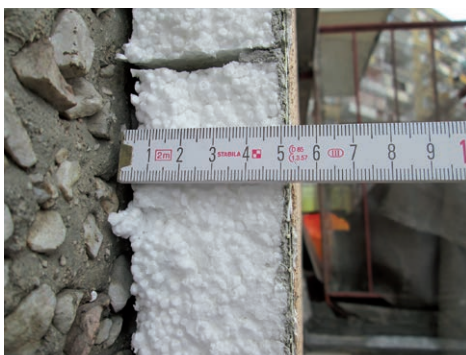
FOT. 7. Pomiar grubości ocieplenia podczas oceny odkrywkowej; fot. archiwum autora
