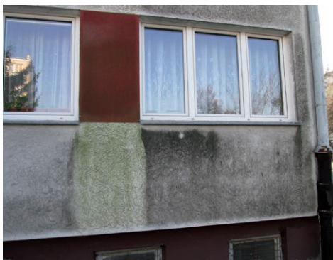
FOT. 24. Ocena stanu zabrudzenia powierzchni tynków – silne zabrudzenie z miejscowym skażeniem mikrobiologicznym; fot. archiwum autora
