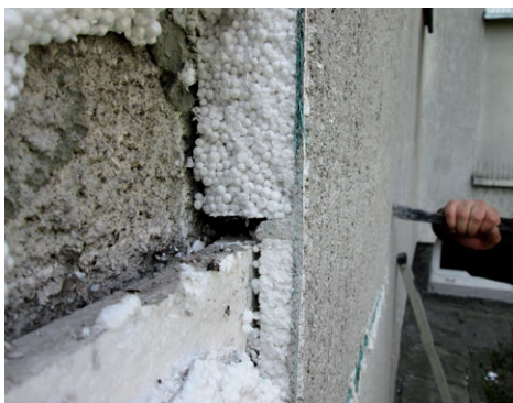
FOT. 5. Tzw. podklejki oraz brak styku płyt – mostek termicznych liniowy; fot. archiwum autora
