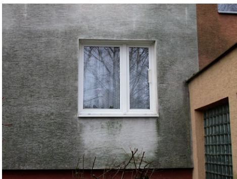
FOT. 22. Ocena stanu zabrudzenia powierzchni tynków – silne zabrudzenie; fot. archiwum autora
