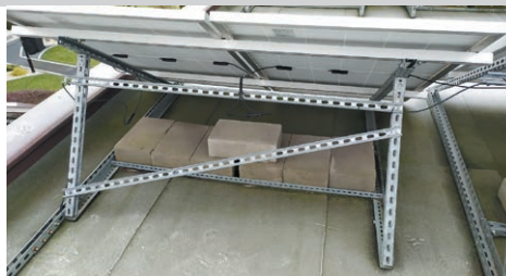
FOT. 2. Nieprawidłowy montaż instalacji fotowoltaicznej – mała powierzchnia styku, duży balast; fot.: Eko Projekt Sp. z o.o.
