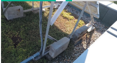
FOT. 1. Nieprawidłowy montaż instalacji fotowoltaicznej – konstrukcja mocowana do bloczków betonowych; fot.: Eko Projekt Sp. z o.o.
