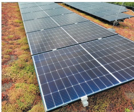
FOT. 1. Połączenie fotowoltaiki i dachu zielonego;
