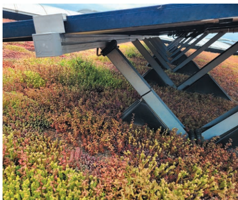
FOT. 2. Rozchodniki na dachu biosolarnym;
