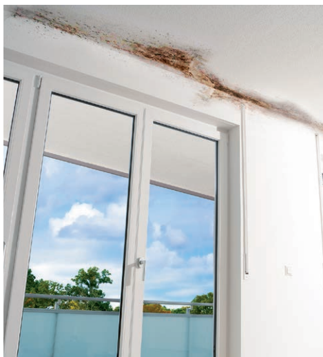
RYS. 6. Zagrzybienie w narożniku ściany i sufitu. Grzyb pleśniowy tworzy się, kiedy stworzone zostaną dla niego odpowiednie warunki – niska temperatura na powierzchni przegrody, wilgotność w pomieszczeniu i czas; rys.: Schöck
