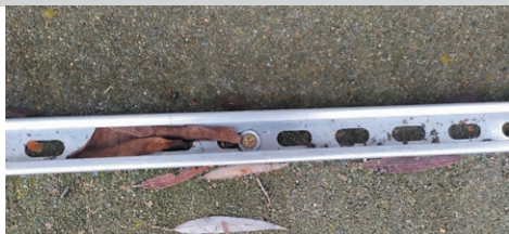
FOT. 3. Nieprawidłowy montaż instalacji fotowoltaicznej – mocowanie mechaniczne przez papę; fot.: Eko Projekt Sp. z o.o.
