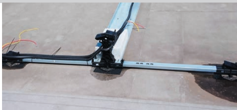
FOT. 4. Nieprawidłowy montaż instalacji fotowoltaicznej – zbyt duże obciążenia punktowe oraz źle dobrana warstwa separująca; fot.: Eko Projekt Sp. z o.o.
