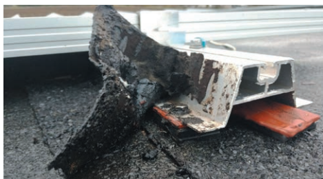
FOT. 5. Nieprawidłowy montaż instalacji fotowoltaicznej – mocowanie mechaniczne i uszczelnienie mocowania; fot.: Wind Projekt Sp. z o.o.
