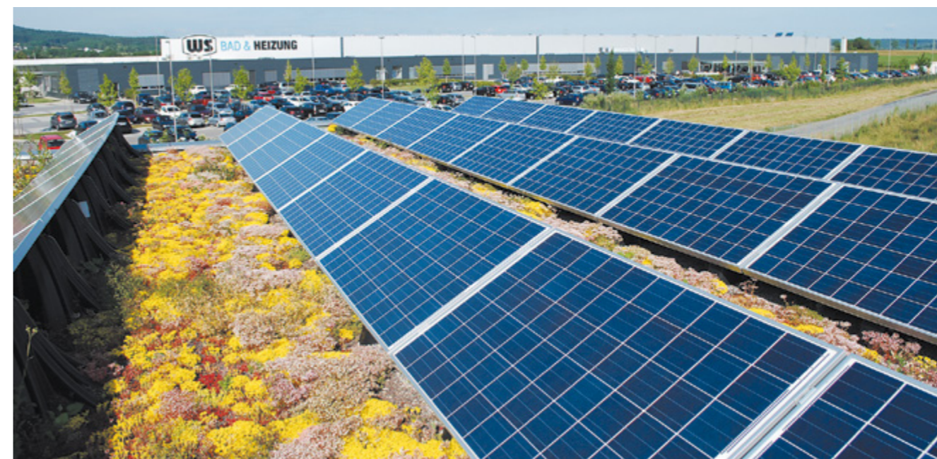
Połączenie dachu zielonego z panelami fotowoltaicznymi podnosi efektywność instalacji solarnej
