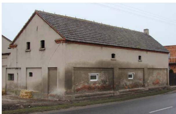
FOT. Budynek zawilgocony na skutek braku prawidłowej ochrony przed wodą; fot.: autor
