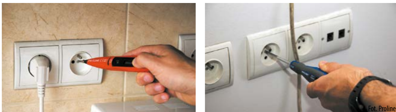
Przystępując do wymiany gniazdka, pamiętajmy o odłączeniu zasilania instalacji elektrycznej. Najlepiej odciąć prąd głównym wyłącznikiem lub przynajmniej przeznaczonym do odłączania danego obwodu. Aby upewnić się, że w gniazdku nie ma napięcia, należy sprawdzić to za pomocą próbnika napięcia. Do pracy przy sprzęcie podłączonym do instalacji elektrycznej należy używać przyborów przeznaczonych do prac elektrotechnicznych. Ich powierzchnia, poza małym fragmentem części roboczej, pokryta jest specjalną warstwą izolacji odpornej na napięcie do 1000 V, czyli znacznie wyższe niż w domowej sieci elektrycznej, które wynosi 230 V
